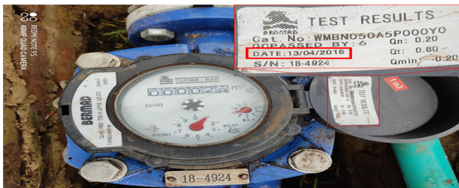
Fotografía 5. Medidor volumétrico instalado en el pozo pz-11-0223
