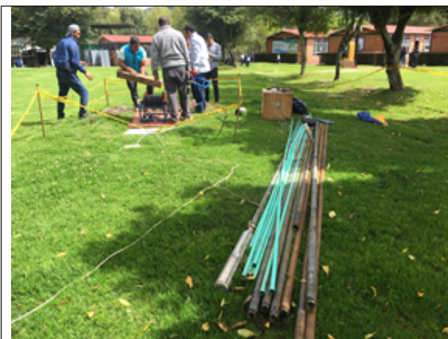
Fotografía 1. Tubería de producción y de niveles
